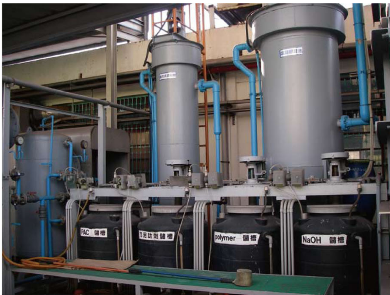
飛龍台灣工廠的廢水處理系統。（圖片提供／飛龍）
